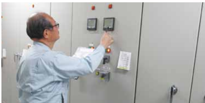
電気設備点検
